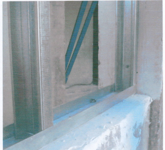
Foto 2: Detalhe da fixação da estrutura metálica no vão do pórtico de concreto
