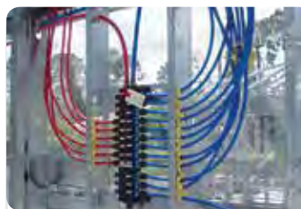
Sistema hidráulico tipo PEX
